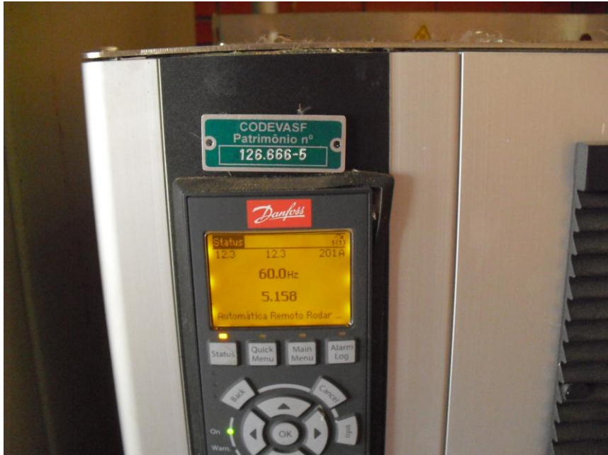
Figura 6.30 – Detalhe de um inversor de frequência instalado numa estação de bombeamento secundária do Perímetro de Irrigação Nilo Coelho - Brasil
