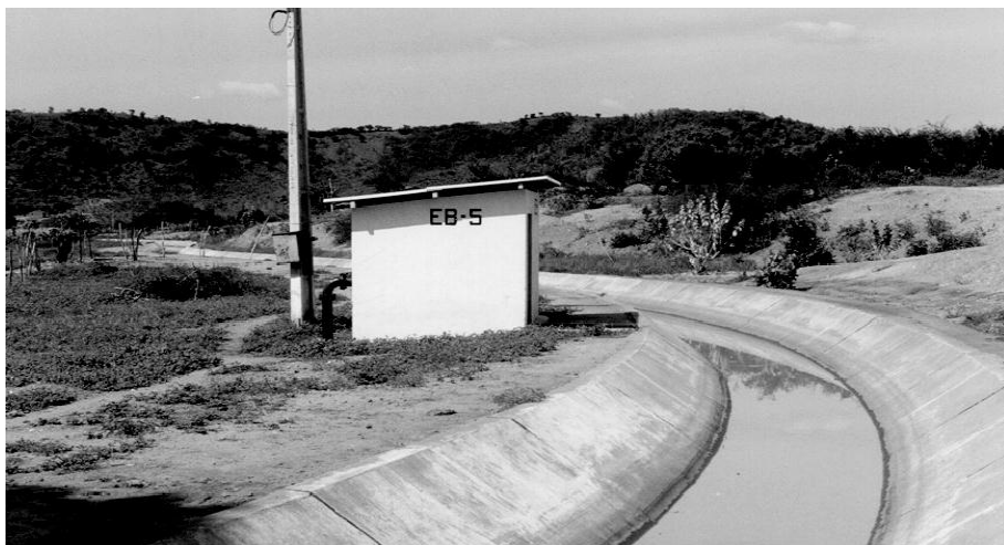
Figura 5.3 - Canal adutor e estação de bombeamento secundária do perímetro irrigado de Gravatá – Paraíba, Brasil
