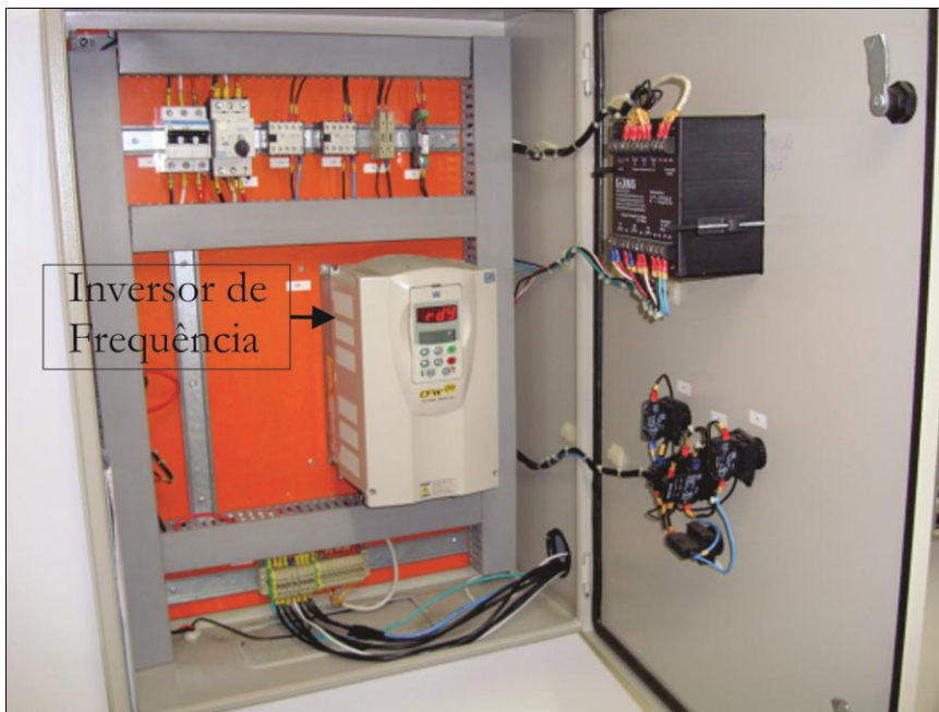
Figura 6.31 – Inversor de frequência instalado num quadro de comando de um conjunto motobomba do LENHS/UFPB – João Pessoa, Brasil
